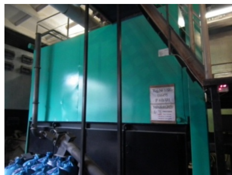
2.7.b. att. Šķeldas katls Kalnsētas ielā 37, Saldū
